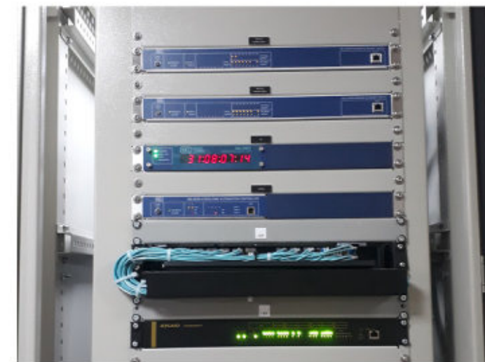
Imagen 8. Tableros de comunicaciones y control – SE Junín
