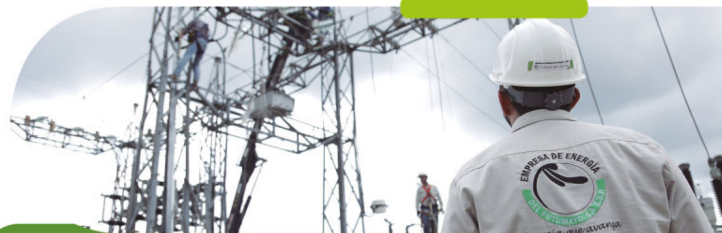
Subestación Junín - las labores de recuperación desde la catástrofe del 2017 han sido constantes y han requerido una importante inversión.
